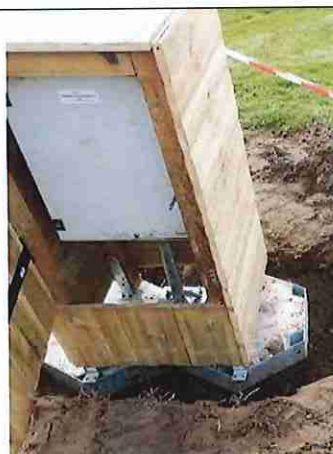
Exemple de coffret en bois pour POE et Bac à Batterie
