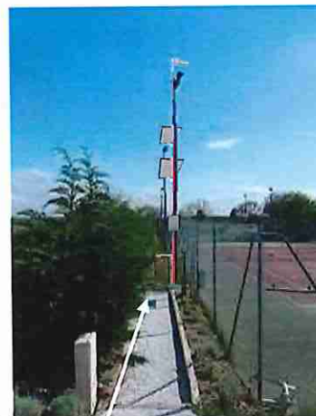
POE Injector et bac a batterie
